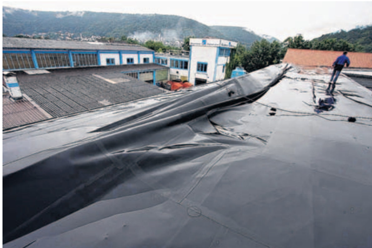
Neben zahlreichen Fahrzeugen wurden am Mittwochnachmittag vor allem Geschäftsgebäude und Lagerhallen im Industriegebiet Bestenheid beschädigt. Unser Bild zeigt ein in Mitleidenschaft gezogenes Dach bei König & Meyer.
